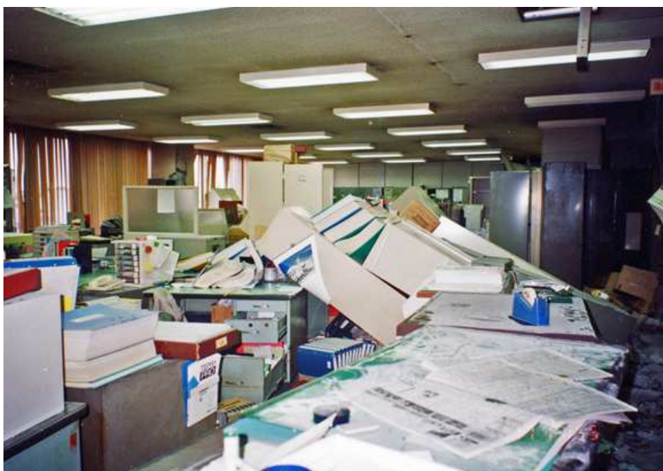
図表 23 阪神・淡路大震災における西宮市役所の執務室及び廊下の状況
