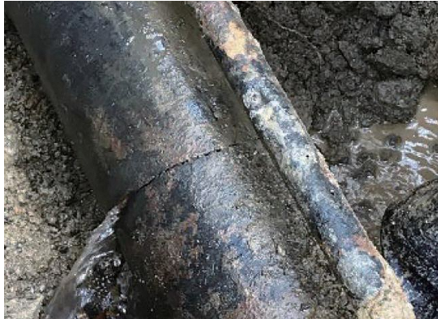
鋳鉄管の漏水
