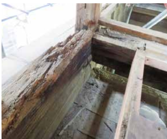
図 4-86 2階会議室東壁胴差腐朽状況
