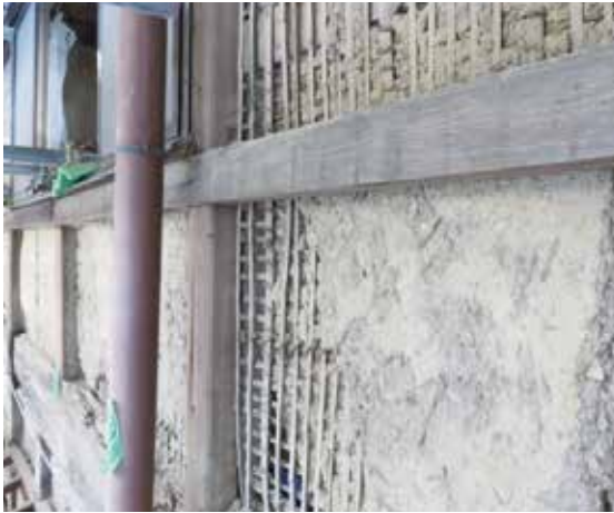
図 4-66 2階南外壁漆喰こそげ落し状況
