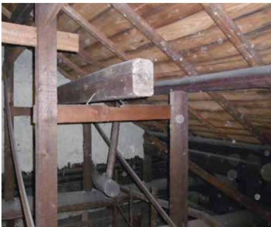
図 4-34 修理前（小屋組の緩み）
