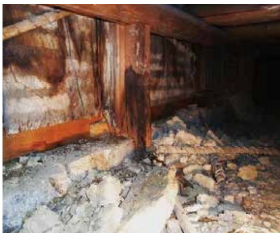
図 4-50 修理前（床組、腰壁の蟻害と脱落）
