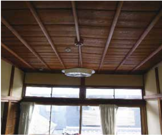
図 4-42 修理前 (2階板間の天井うねり)
