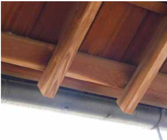
図 4-36 修理前（軒樋の腐食）
