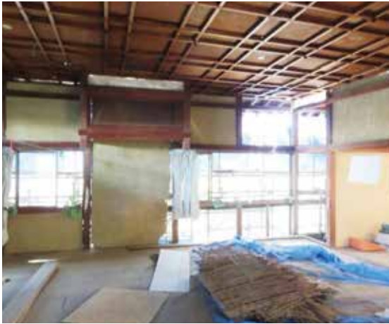
図 4-88 2階会議室漏水損傷壁撤去状況
