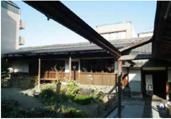
図 2-31 修理前 (外観南面)
