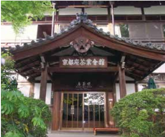
図 4-10 修理前 (玄関構え)
