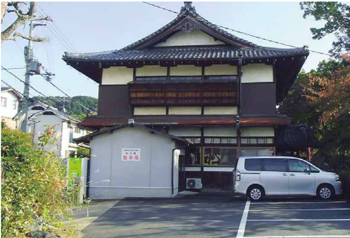
図 4-9 修理前外観（北面 平成 24 年）
