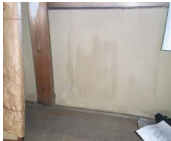
図 4-47 修理前 (2階会議室東壁の汚損)
