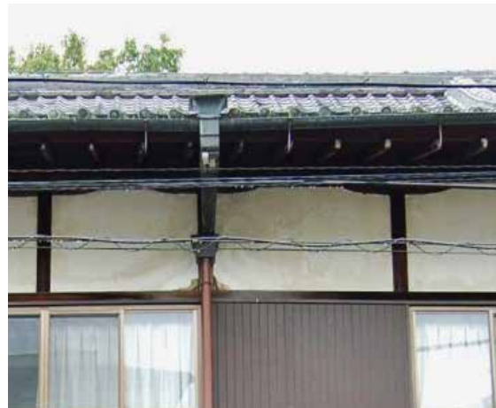
図 4-37 修理前（樋の漏水による東外壁損傷）
