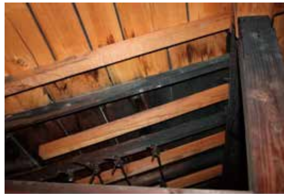
図 2-16 越屋根部分を塞いだ跡
