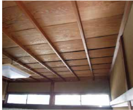
図 4-43 修理前 (2階座敷の天井のばらつき)
