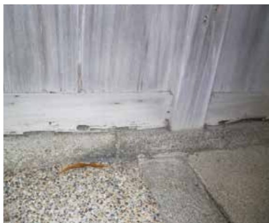
図 4-49 修理前（1階西面付け土台の蟻害）
