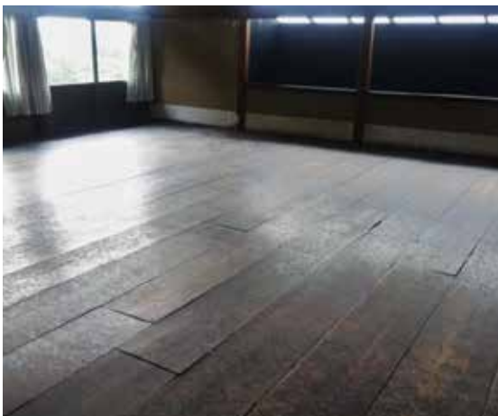
図 4-46 修理前 (2階会議室の床歪み・盛上り)
