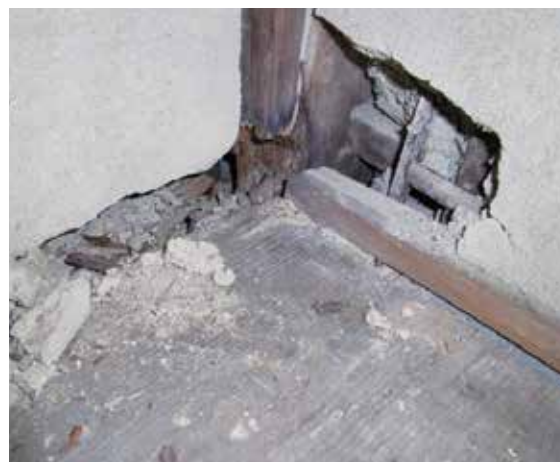
図 4-41 修理前（漏水による構造材腐朽）
