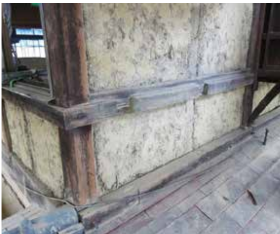
図 4-64 2階北・東外壁漆喰こそげ落し状況
