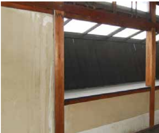
図 4-38 修理前（漏水による北内壁汚損）
