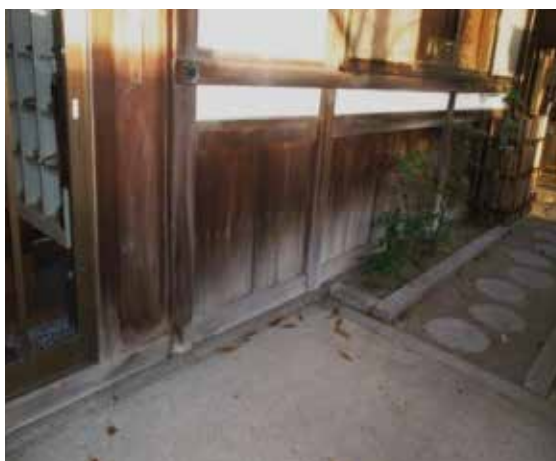
図 4-48 修理前（玄関横の腰板と残る釘隠）
