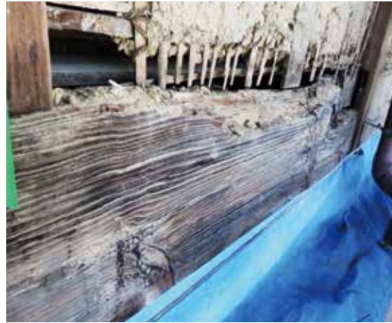
図 4-67 2階東壁の漏水による壁・胴差腐朽
