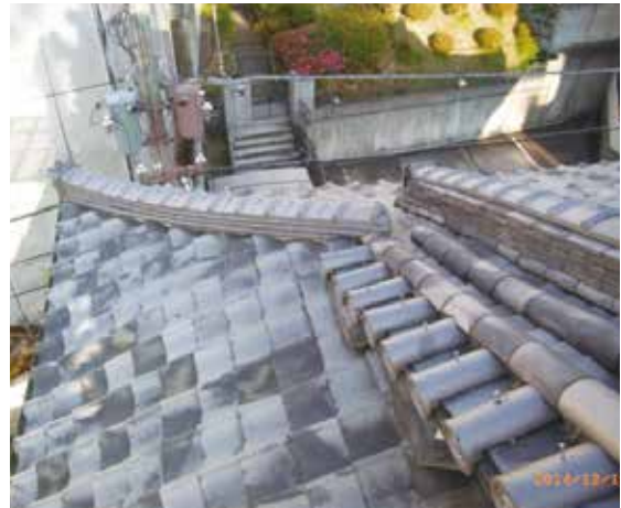
図 4-33 修理前（降棟と隅棟の取合いの隙間）
