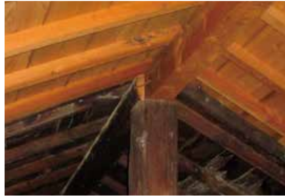
図 2-14 越屋根部分を塞いだ跡と火災跡
