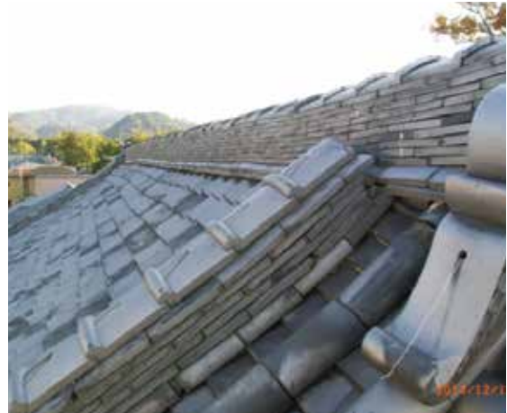
図 4-31 修理前（棟と降棟取合いの隙間）
