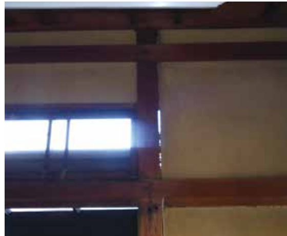
図 4-45 修理前 (2階会議室北壁の隙間)
