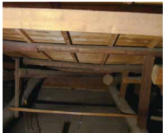
図 4-35 修理前（母屋の垂れ下り）
