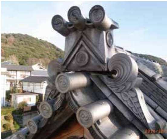
図 4-32 修理前（棟北獅子口の割れ）
