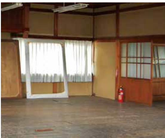
図 4-40 修理前（漏水による東内壁破損）
