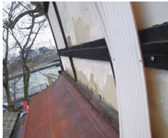
図 4-39 修理前（南外壁の剥落状況）
