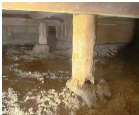
図 4-51 修理前（床組、束の蟻害）
