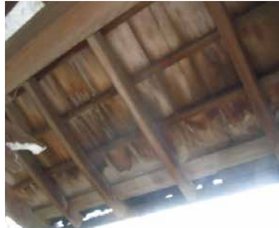
図 4-55 修理前（玄関 軒の腐食状況）
