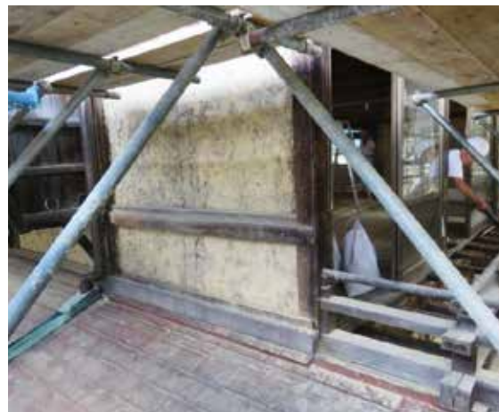
図 4-65 2階外壁漆喰こそげ落し胴差等腐朽状況
