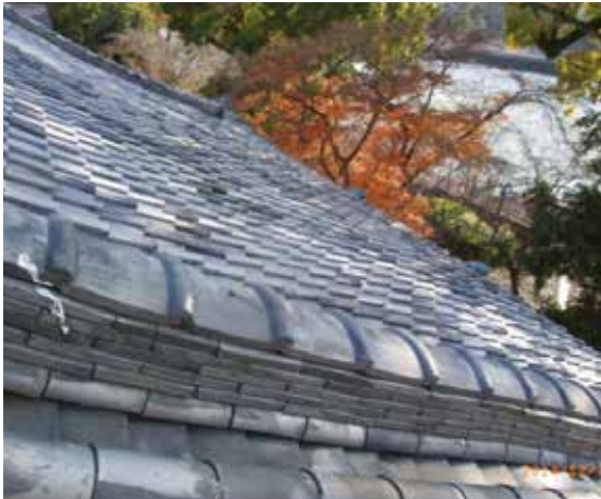
図 4-30 修理前（瓦のうねり、凍害）
