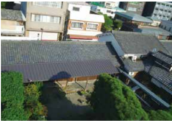
図 2-33 修理前 (外観南面)
