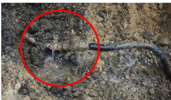
鉛製給水管からの漏水状況（拡大写真）
