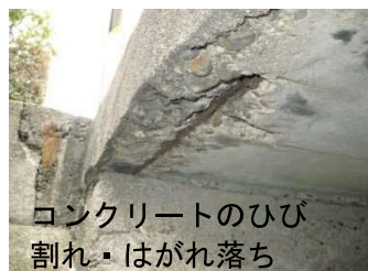
橋梁の損傷例
